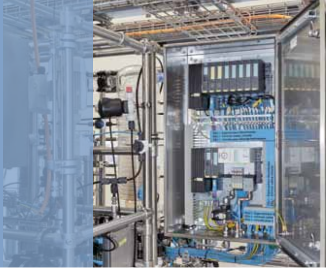
Hochmodulares Schaltschrankkonzept – Engineering made by Bürkert
