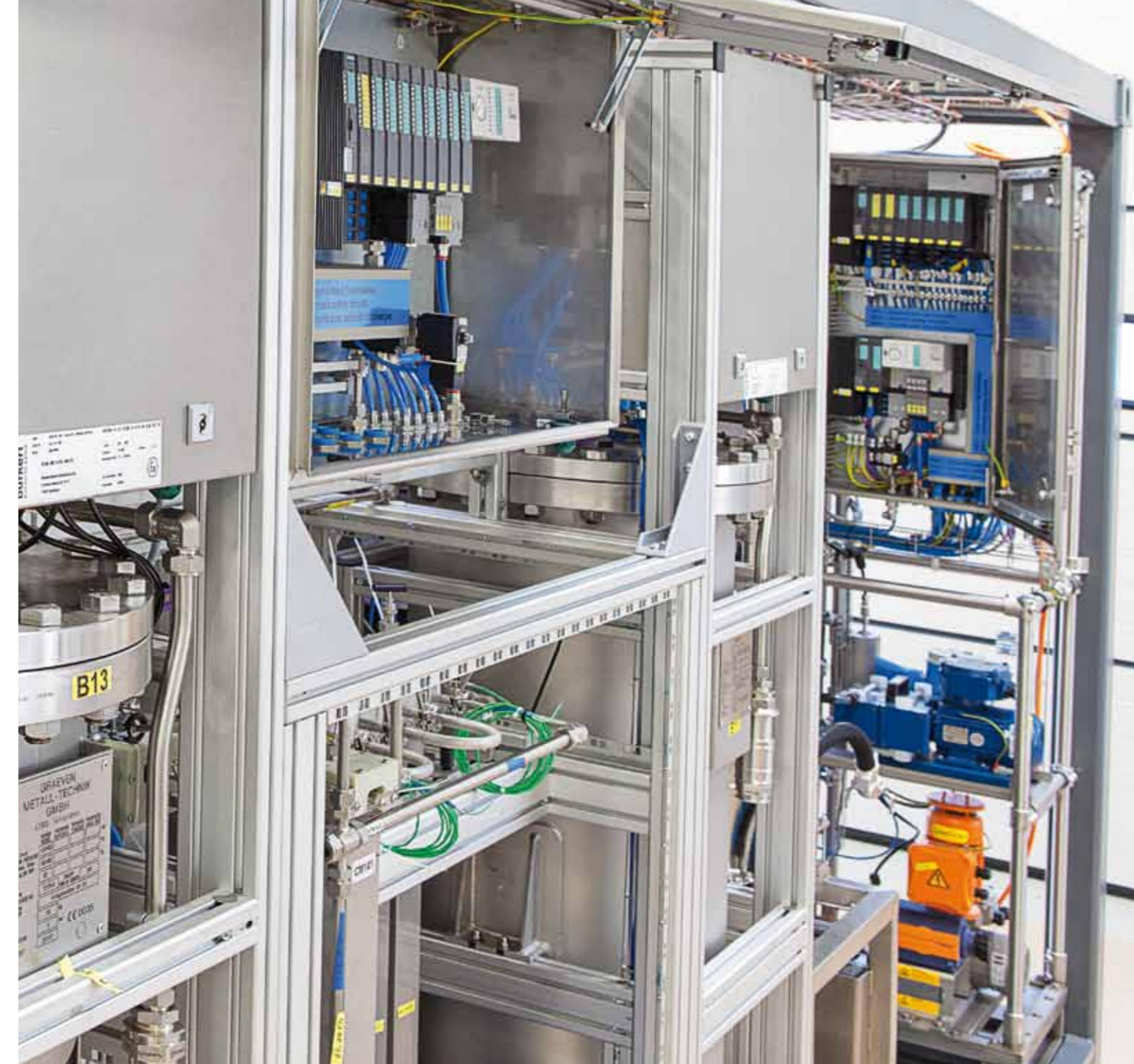
In Reih und Glied – Bürkert Schaltschränke für die unterschiedlichen Containermodule
