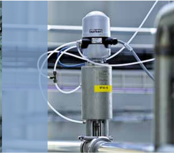
Materialflusssteuerung durch feldbusgesteuerte Lebensmittelventile
