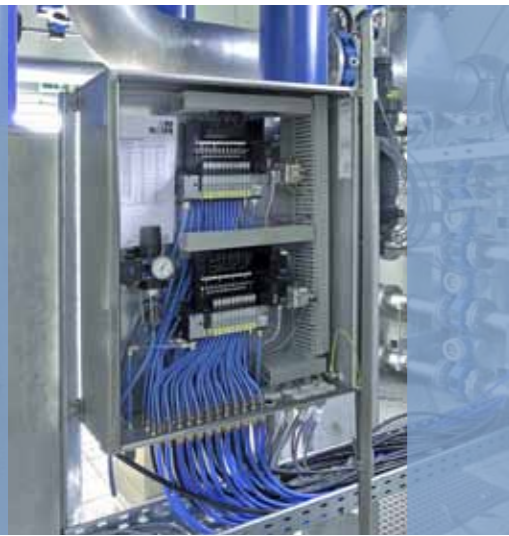
Pneumatikschrank von Bürkert zur Filtersteuerung
