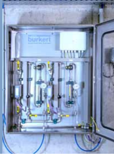
Oxidatorbox von Bürkert – Innenansicht im Wasserwerk der Gemeindewerke Everswinkel
