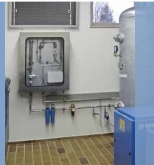
Oxidationsluftregelung im Wasserwerk Tarmstedt: Vorher (links) und nachher (rechts).
