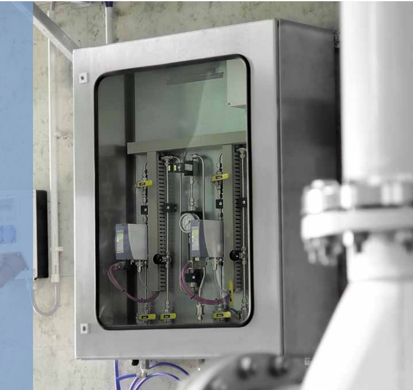
Oxidatorbox von Bürkert: Zweikanalsystem im Wasserwerk der Gemeindewerke Everswinkel
