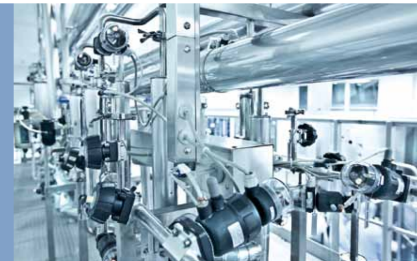
Armatureninstallation im Reinraum der neuen LIFE Nutrition Anlage bei B. Braun in Melsungen
