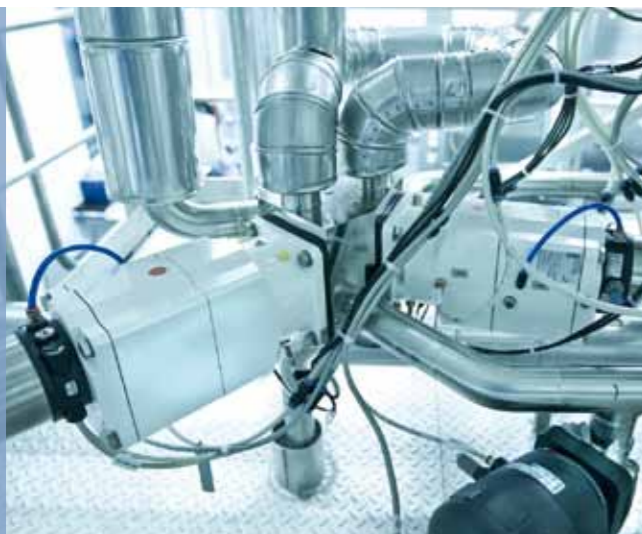
Positioner 8696 im Verbund mit Robolux RV110 zur Dampfregelung
