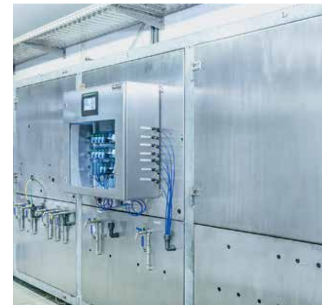
Nachher: Kompakte Installation der Messtechnik im Edelstahlschrank.
