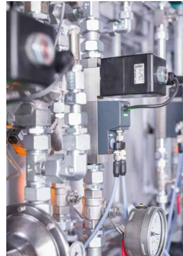
Systemtechnisches Know-how ermöglicht einfache Inbetriebnahme eines neuen Rollenherdofens
