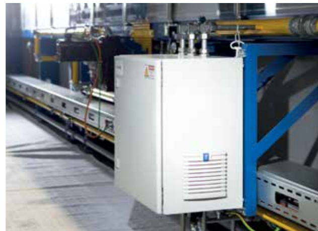
Rollenherdöfen dienen für das Presshärteverfahren hochfester Stähle, die als sicherheitsrelevante Strukturteile u.a. im Automobilbau Verwendung finden. (Bild: schwarz GmbH)
