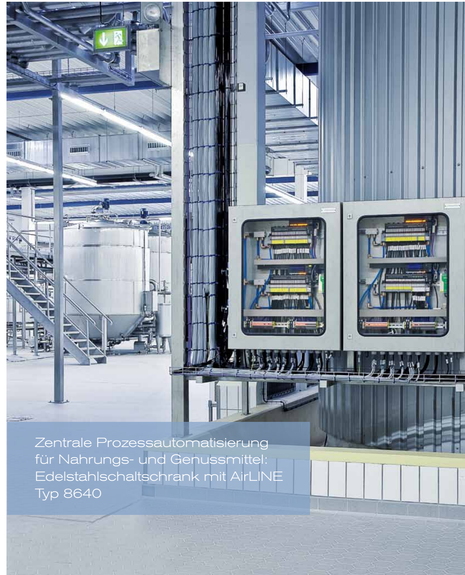
Systemlösung: Edelstahlschaltschrank mit AirLINE Typ 8640 steuert Käseeriprozesse
