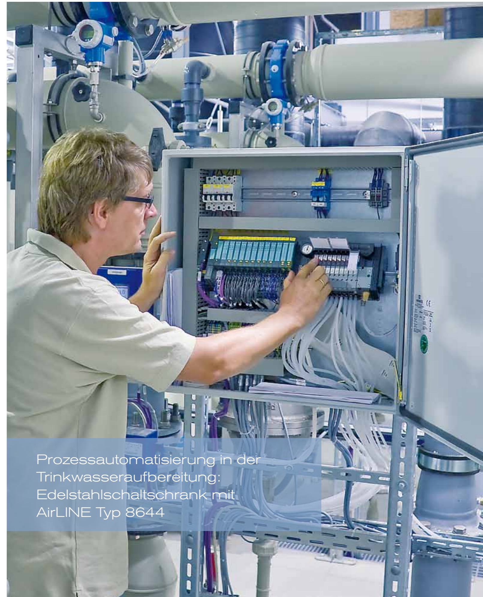
Automatisierungssystem AirLINE Typ 8644 in der Wasseraufbereitung
