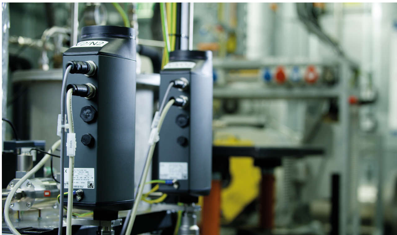
Elektromotorische Prozessregelventile regeln die Gaszufuhr
