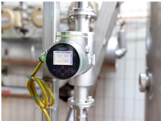
Durchflussmesser vor dem Eindampfer
